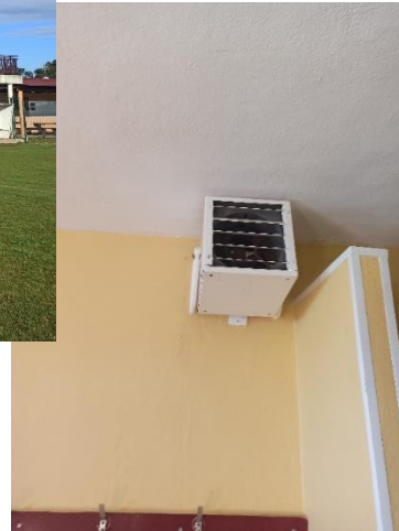
Système de chauffage énergivore
